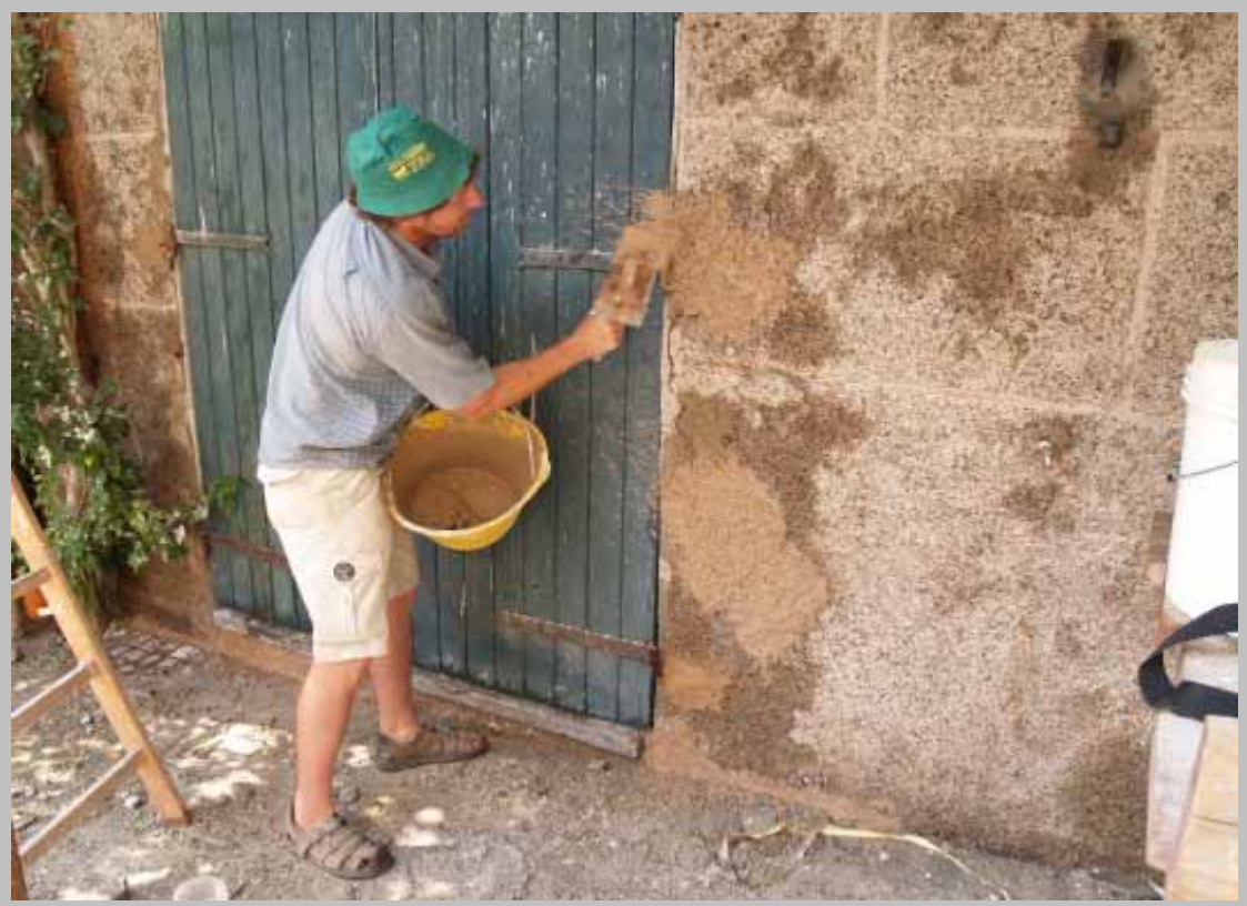
12 - Ripristino delle parti ammalorate del basamento, con malta a base di cemento e sabbia di fiume locale
