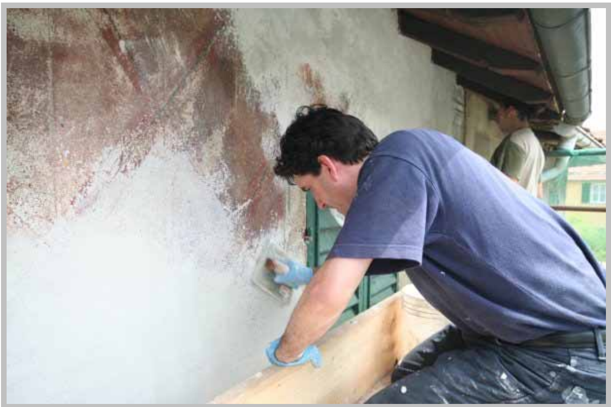
4 - Ripristino della finitura originale dell'intonaco con malta di grassello di calce, polvere di marmo e sabbia di fiume fine
